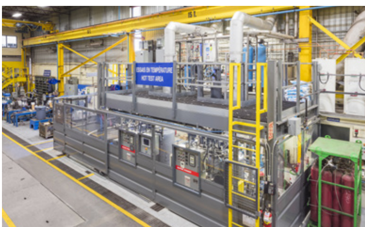
Photo : Mezzanine de protection pour machine avec cloisons
